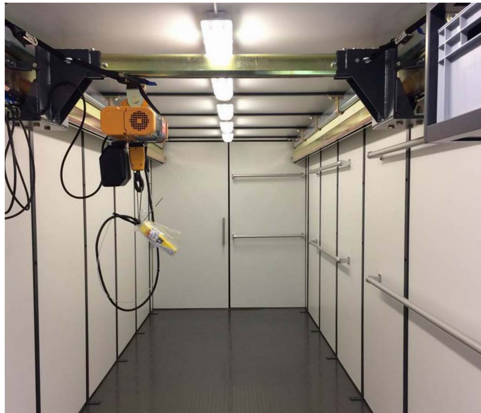
In einem Container installiertes Leichtkransystem.
