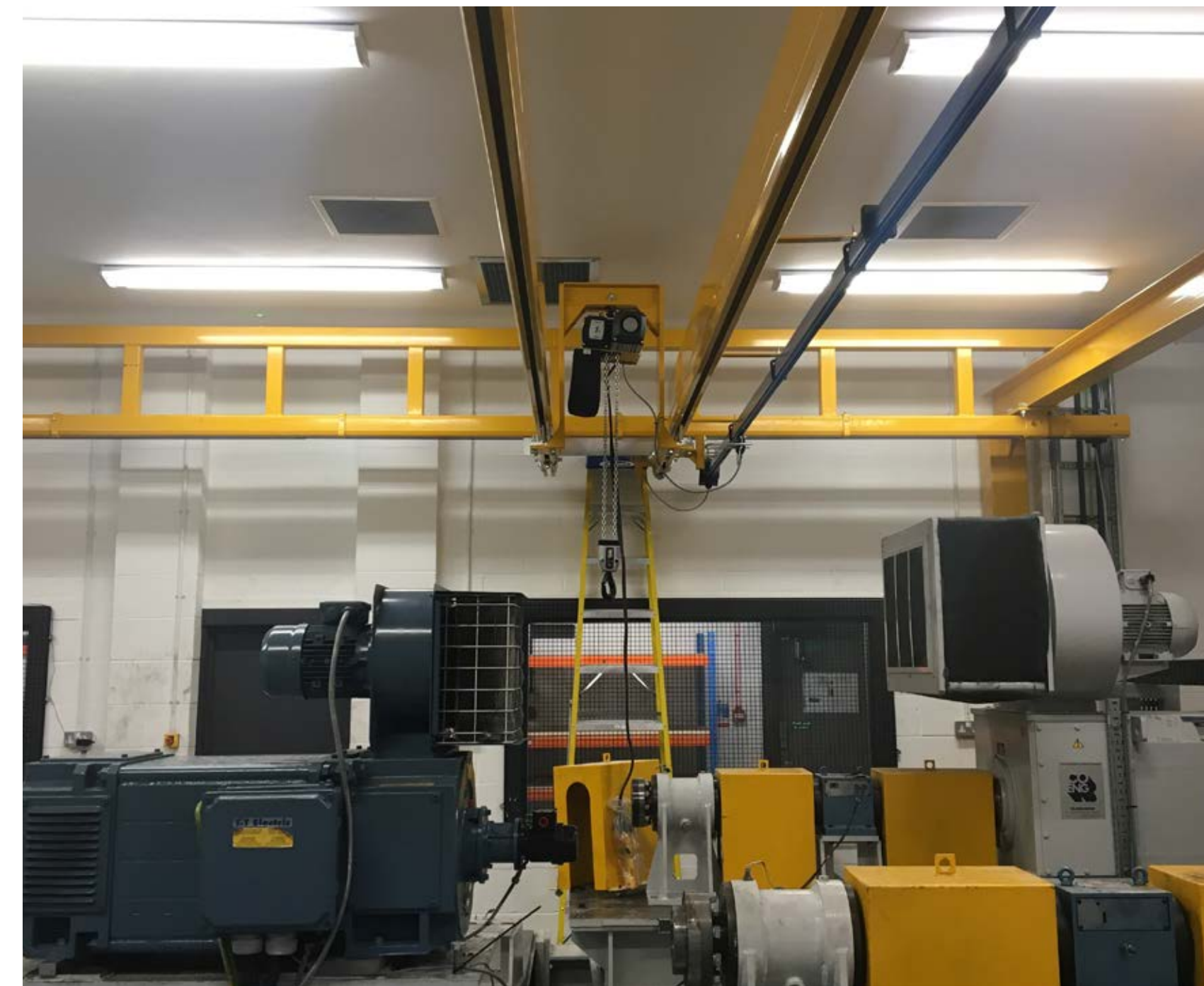
Kransystem mit niedriger Bauhöhe und hochgezogenen Trägern (Brücken) zwischen den Fahrschienen.
